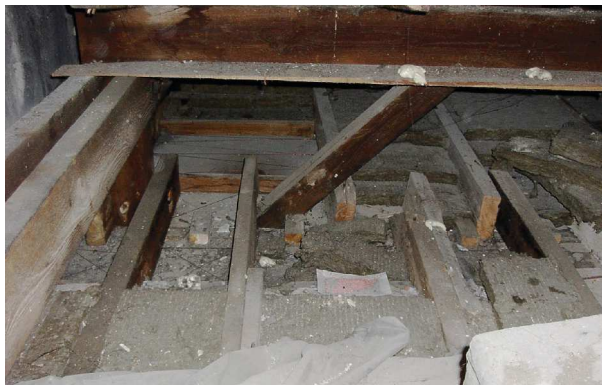
Stan techniczny ocieplenia stropu nad wybudówkami
